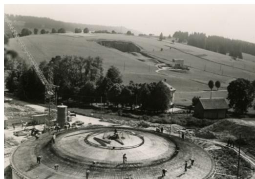
Construction du réservoir du Vuillème, à La Chaux-de-Fonds, dans les années 1950 (Collection Mémoires d'Ici)
